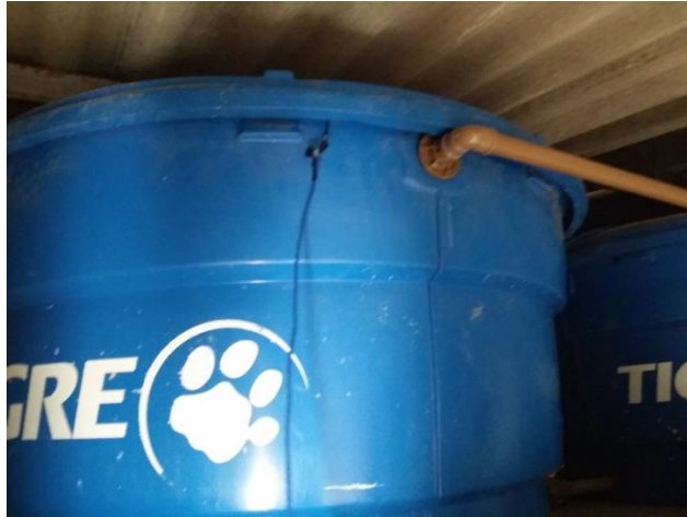
Figura Anexo 14: Caixa d' água com sensor de água fria instalado
