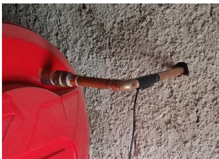
Figura 12: Ilustração do modo de fixação do sensor na tubulação de cobre.
