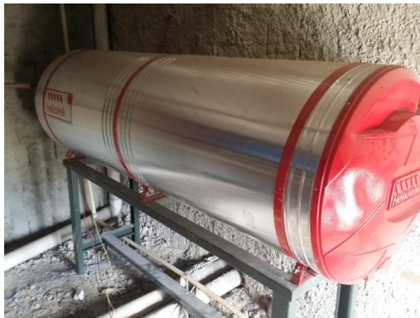
Figura Anexo 15: Boiler instalado na residência.
