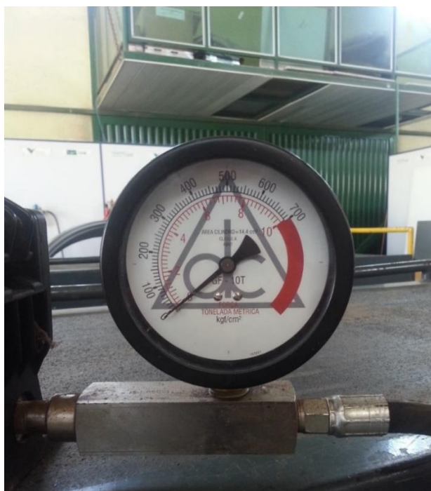
Figura 35 – Detalhe do manômetro acoplado à bomba.
