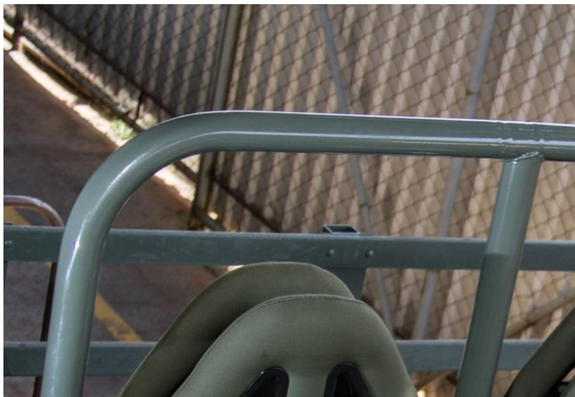
Figura 22 – Curvatura no topo do arco principal.
