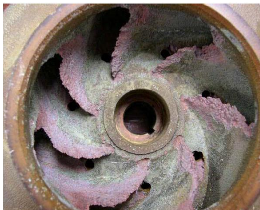
Figura 14 - Rotor de uma bomba submetido à erosão e corrosão (Ochoa, 2007)
