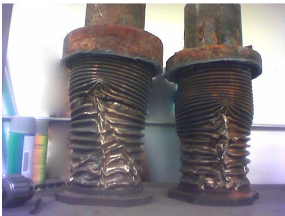
Figura 2 - Tubulação danificada por golpe de aríete.
