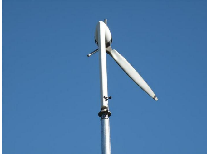
Figura 13. Turbina eólica com uma pá. ( www.odt.co.nz . Acesso em: 2 de maio 2015)
